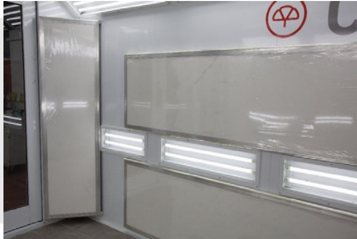
Ilustración 16: Cabina de pintura con paneles endotérmicos
